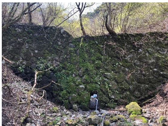
日向薙堰堤（第5号）
